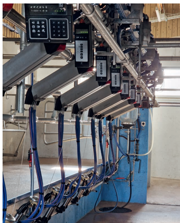
L'utilisation de la ML3100 est un jeu d'enfant. La salle de traite permet d'exploiter «à fond» le potentiel d'un fonctionnement en 2 équipes et de réduire les coûts d'exploitation en même temps.
